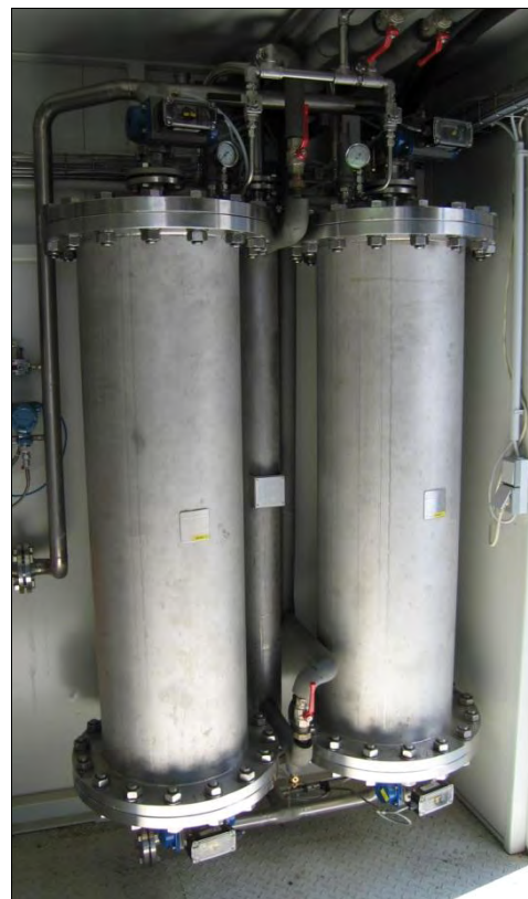
Absoratorer med järnoxid för slutlig avsvavling av biogas
