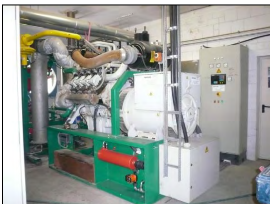
En av de två kraftvärmeanläggningar som installerades från början men numera enbart används som reserv
