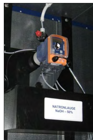
Doseringspump för natriumhydroxid
