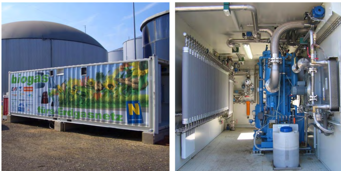
Uppgraderingsanläggningen i Bruck/Leitha sedd utifrån och inifrån, med kompressor, värmeväxlare (till höger) och membranmoduler (till vänster)
