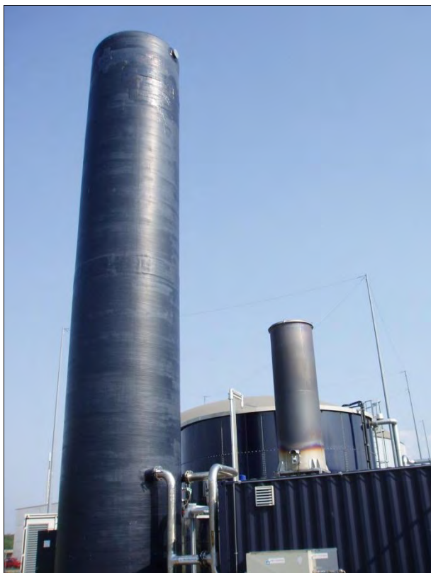
Biologisk skrubber för avsvavling av rå biogas
