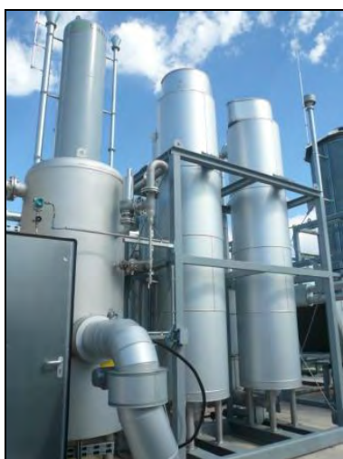
Bufferttank för rågas (till vänster fram), två filter med aktivt kol (i mitten till höger), lagringstank för biometan (till höger bak)
