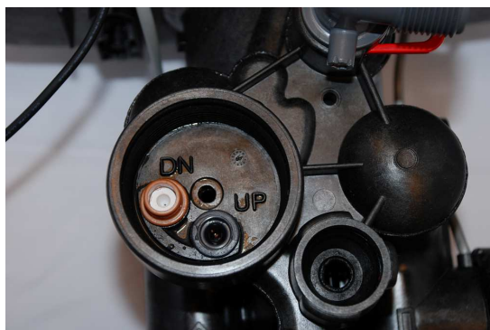
Injektor är placerad i håll med markering "DN". Den är låst i position endast med O-ring.
